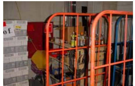
Der Zugang zu den Feuerlöscheinrichtungen wird durch Materiallagerung versperrt.
